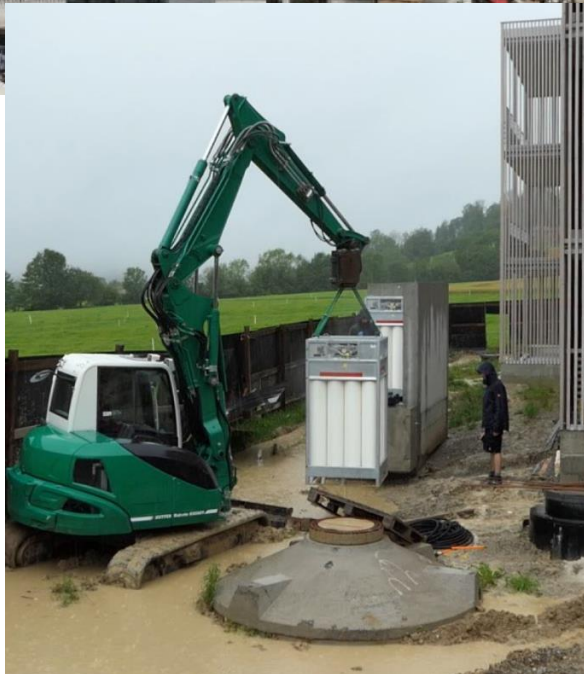
Sockel Wasserstoffspeicher (Gasflaschen)
