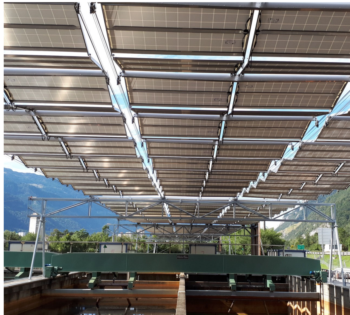
Faltbare Solarmodule über dem Klärbecken in Chur www.dhp-technology.ch/
